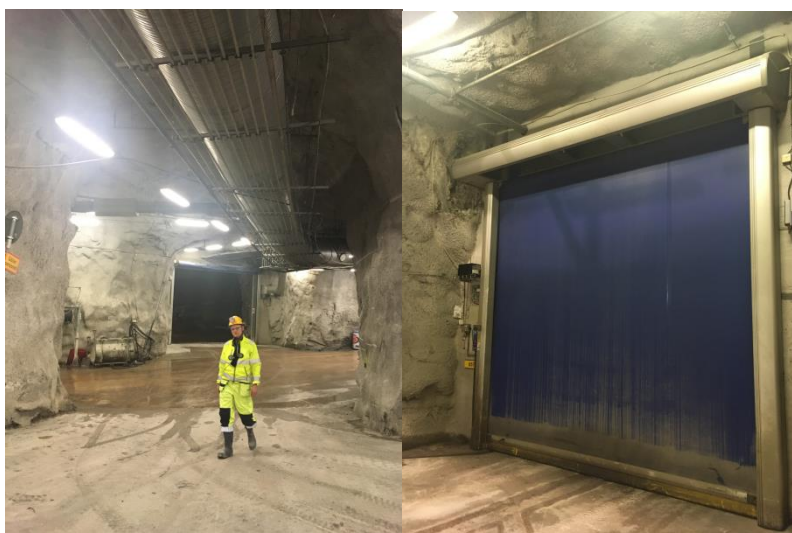
Рис. 2. Пример установки автоматических шторных дверей рулонного типа на техническом этаже.
